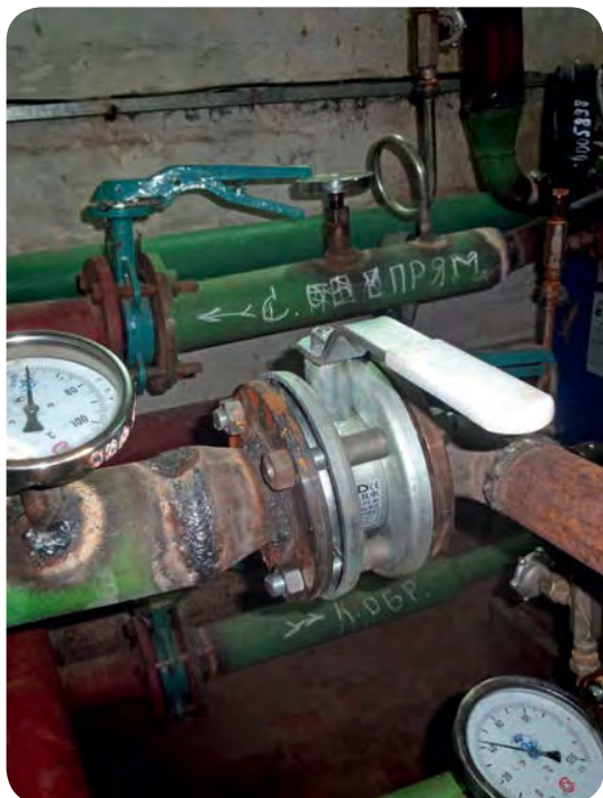
ТЕПЛОПУНКТ (ОБВЯЗКА ТЕПЛООБМЕННИКА)
