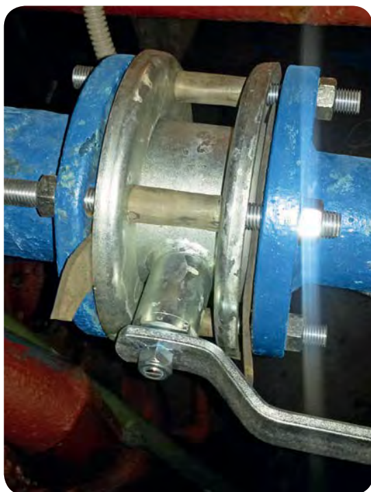
ПОДАЧА В ТЕПЛООБМЕННИК DN 80
