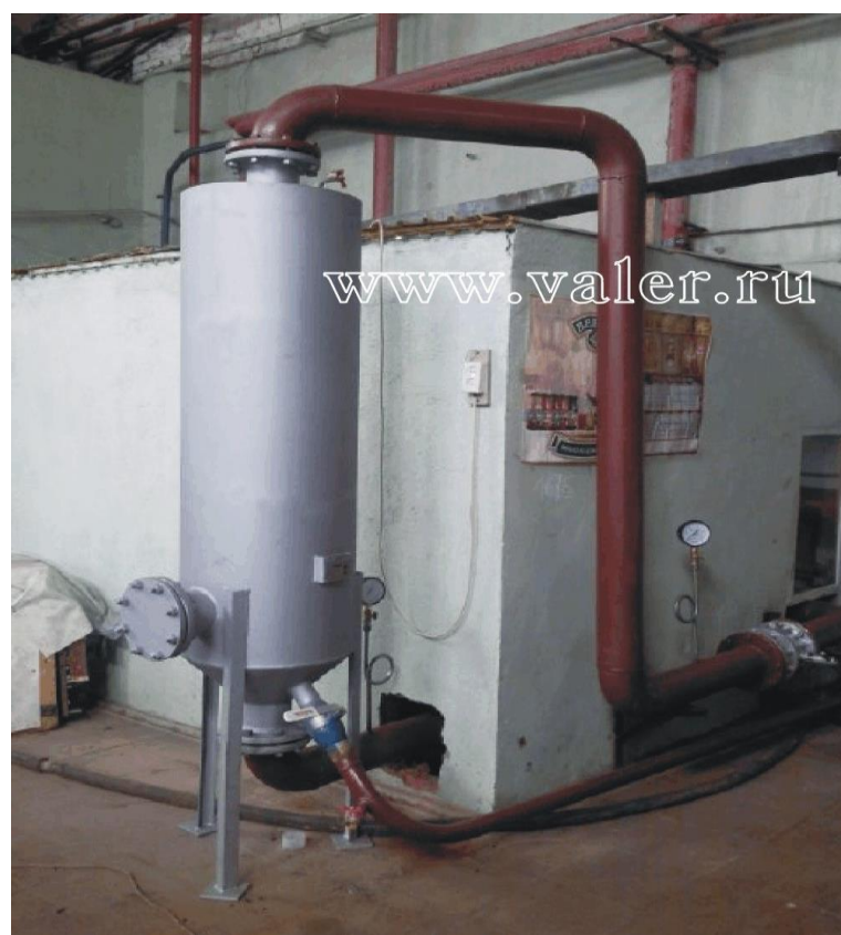
Фото 10. Грязевик ГИГ-90 установлен в 2010 г. на обратном трубопроводе котельной ЗАО «Ленпродмаш» г. Санкт-Петербург
