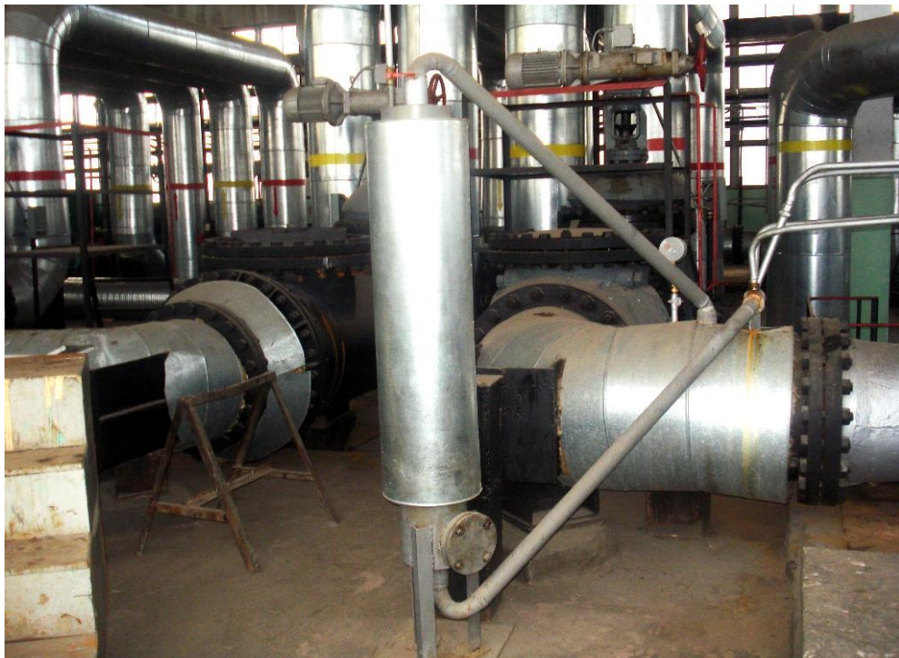
Фото 8. Грязевики ГИГ-20 (6 единиц). Установлены для очистки воды в системе охлаждения подшипников сетевых насосов НПС «Дачное». ОАО ТГК-1 Филиал «Невский» Тепловая сеть г. Санкт-Петербург.
