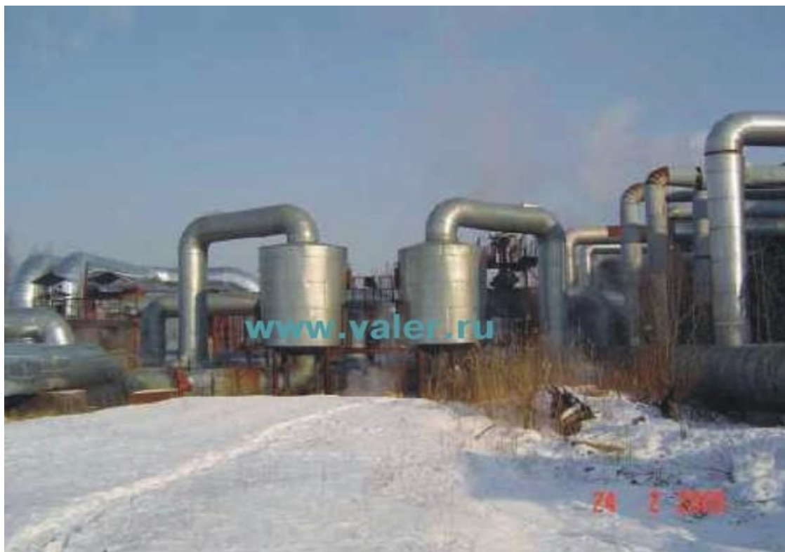
Фото 6. Грязевики ГИГ-5600 установлены в 1995 г. на пиковой котельной «Парнас» ГУП «ТЭК СПб»
