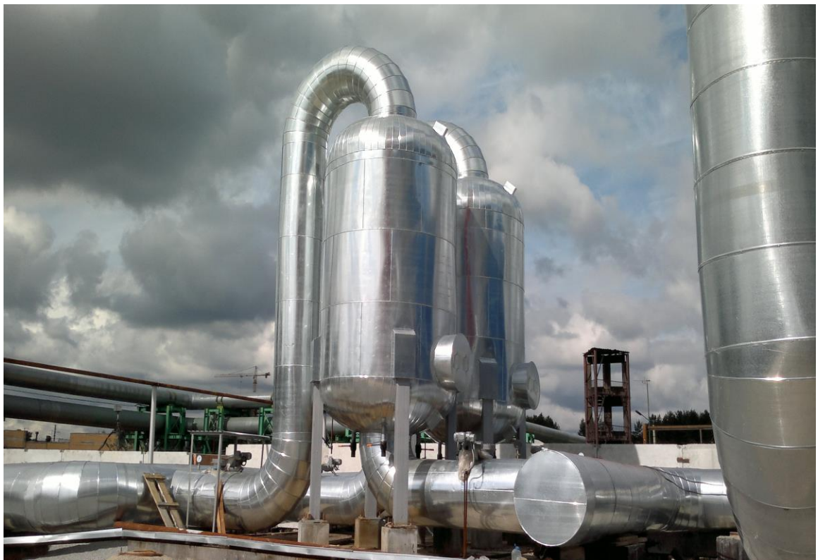
Фото 14. Грязевики ГИГ-3000, установленные на обратных трубопроводах тепловой сети ТЭЦ «Академическая» ОАО «Академэнерго», г. Екатеринбург, 2013 г.
