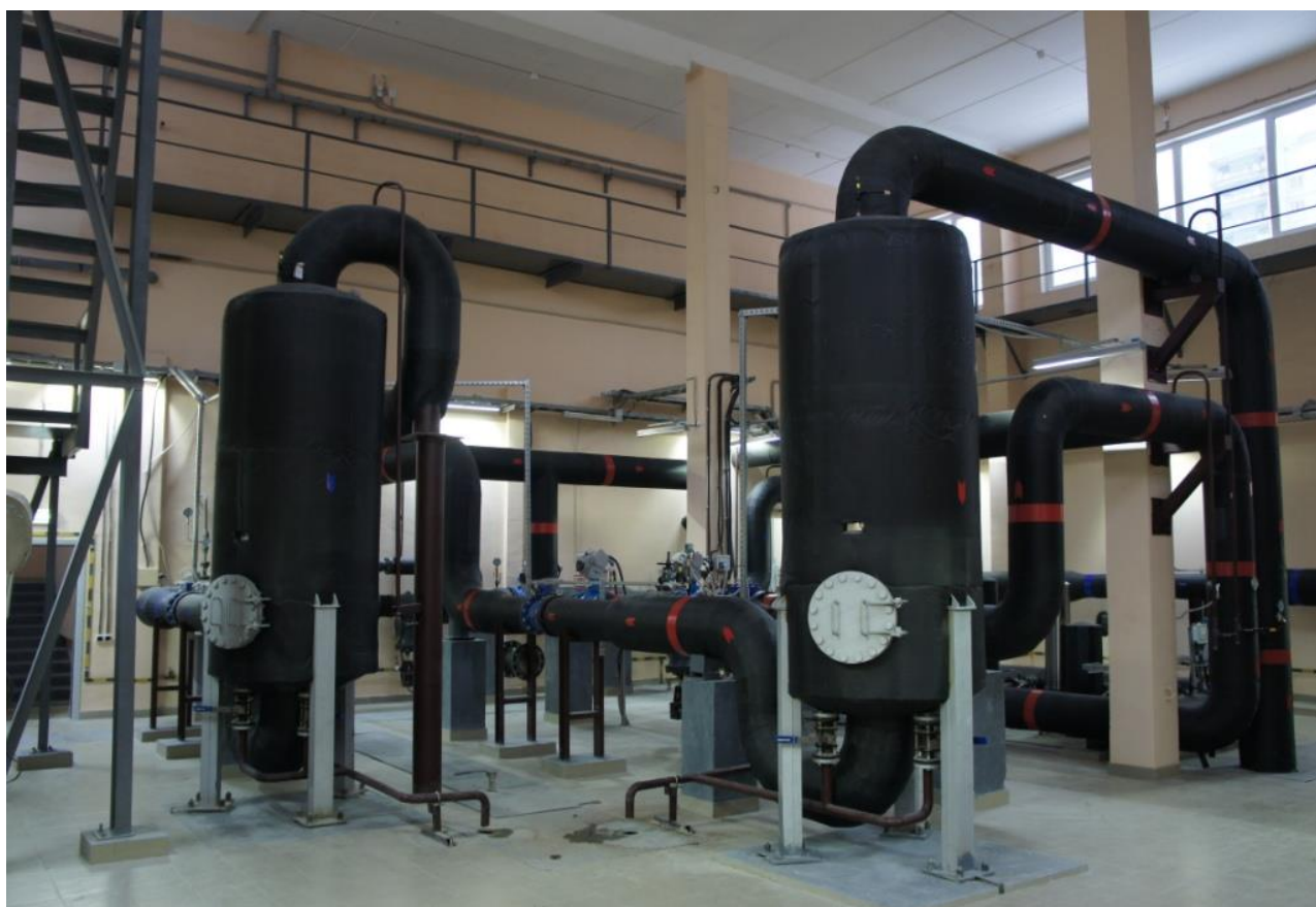
Фото 12. Грязевики ГИГ-450/Рy0,6 на прямом и обратном трубопроводе ЦТП ОАО «ТГК-1»
