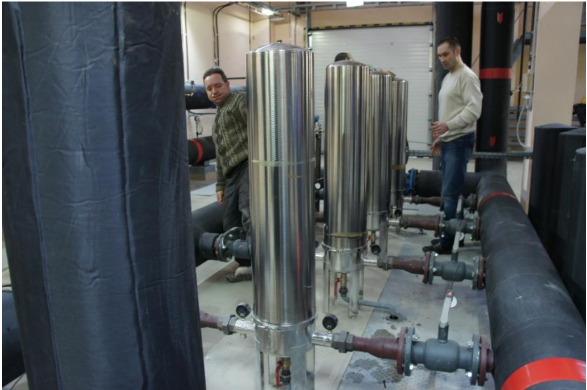
Фото 13. Фильтры тонкой очистки на прямом трубопроводе ЦТП ОАО «ТГК-1»
