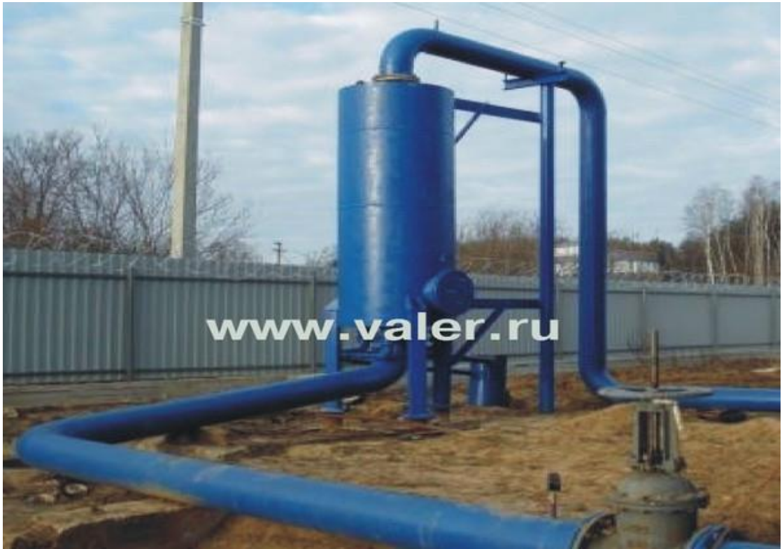
Фото 7. Грязевик ГИГ-350 установлен в МУП "Теплосеть" г. Домодедово.
