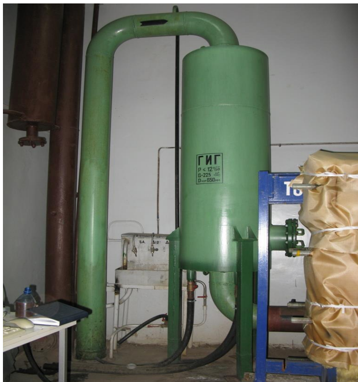
Фото 11. Грязевик ГИГ-225, установленный на вводе водопровода в котельной ЭПК Уральского Федерального Университета. (УПИ)
