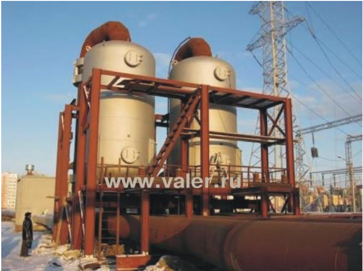
Фото 3. Фильтры-грязевики ГИГ-6000 ВК. Установлены в 2009 г. на Приморской котельной ГУП «ТЭК СПб».
