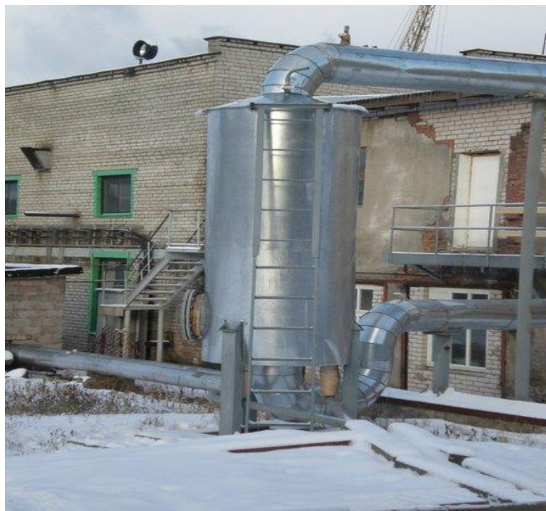
Фото 9. Фильтр-грязевик ГИГ-415 установлен в 2006 г. на обратном трубопроводе котельной ОАО «ПКС. Тепловые сети» г. Петрозаводск
