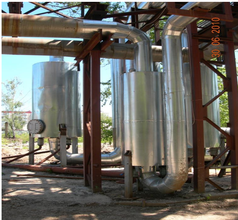
Фото 15. Грязевики ГИГ (R) различной производительности, установленные на обратных трубопроводах тепловых сетей центральной котельной ОАО «Лобненские теплосети».
