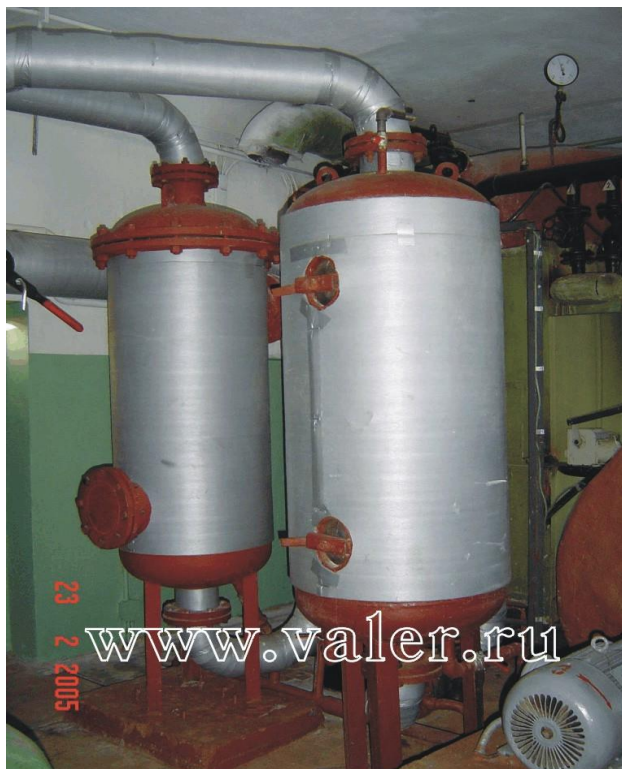
Фото 5. Фильтры-грязевики ГИГ-225 установлены в 2003 году в Государственном музее-заповеднике "Царское Село", г. Пушкин
