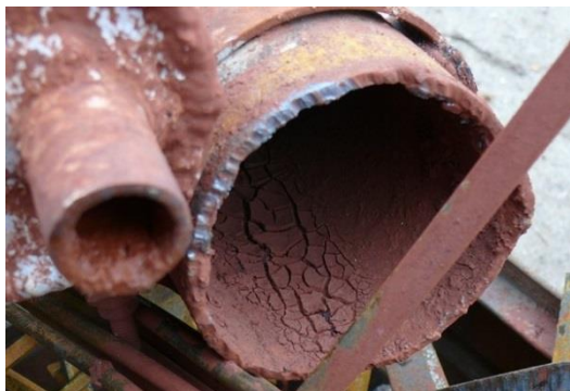
Фото 11. Регистр и горизонтальный трубопровод.
