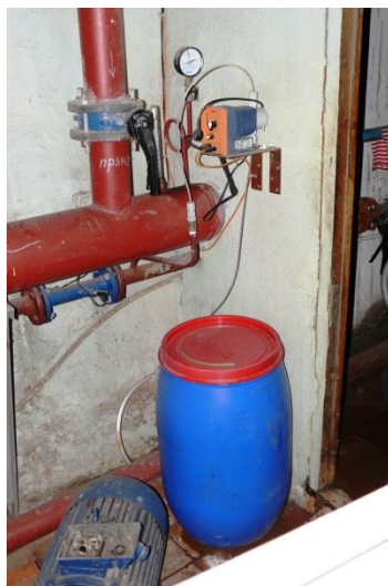
Фото 10. Установка дозирования реагента «СК-110 - коррекционный состав».
