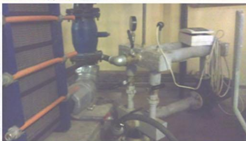
Рис.1. Установка «Мангуст» подключенная к системе теплообменника
