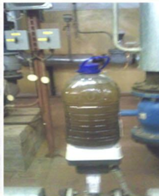
Рис.3. Вода после слива из внутреннего контура теплообменника
